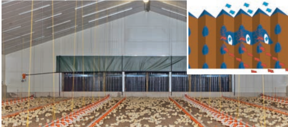
Einsatz des Staubfilters StuffNix in einem Hähnchenstall – durch qualifizierte Messungen wurde eine Gesamtstaubabscheidung von bis zu 70 % und eine Feinstaubabscheidung von 32 % ermittelt.
