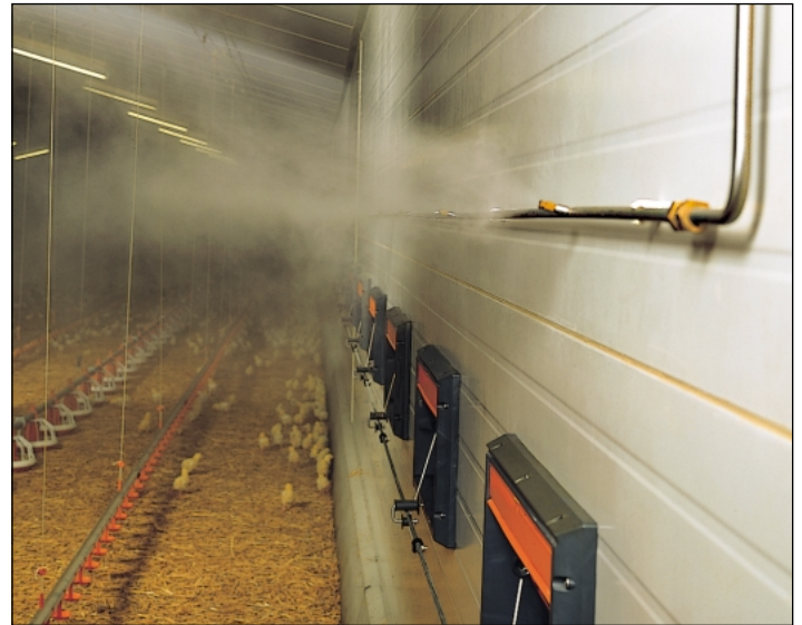
Einsatz des Systems Fogging Cooler im Broilerstall
