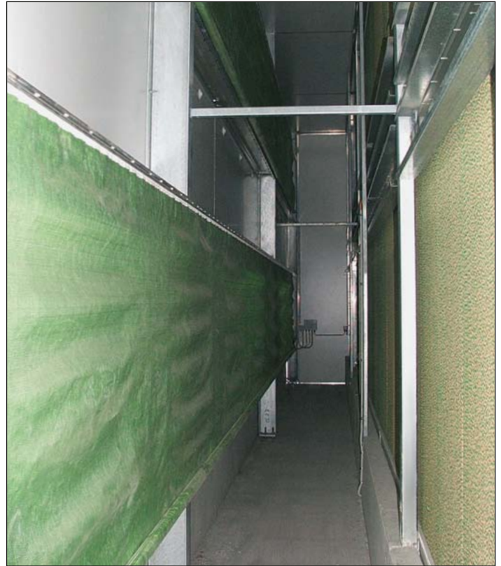
Tunneleinlass mit Rollgardine
