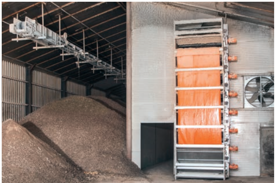
OptiSec mit Kottlager zusammen in einer Halle
