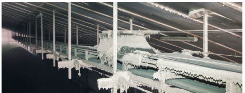
Blick auf ein Verteilerband mit Pflugabstreifer
