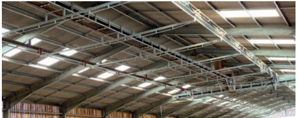
Blick auf einen H-Verteiler
