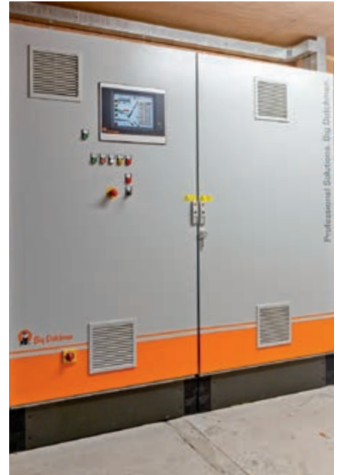
Schaltschrank mit amacs-Funktionsmodul »Kottrocknungstunnel OptiSec«
